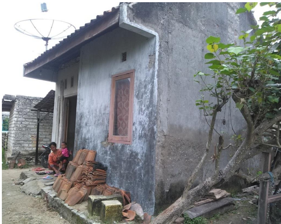
Gambar 3 Kondisi rumah warga
