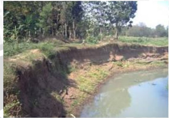
Foto 14. Kondisi Tebing Kali Mungkung pada CP67
