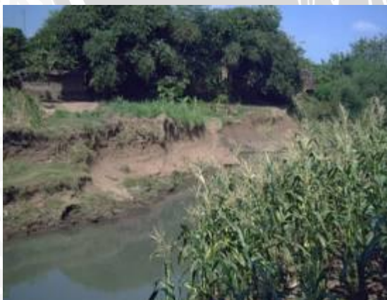
Foto11. Kondisi Tebing Kali Mungkung pada CP116
