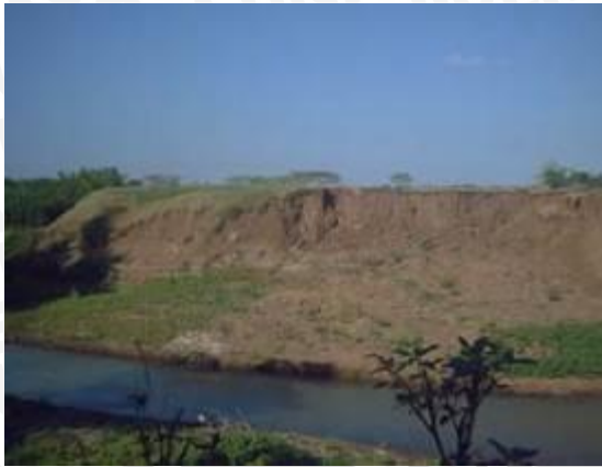
Foto7. Kondisi Tebing Kali Mungkung pada CP 6
