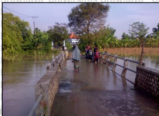
Gambar 2. 2 Prasarana jalan terendam banjir Sumber: Fian, 2016
