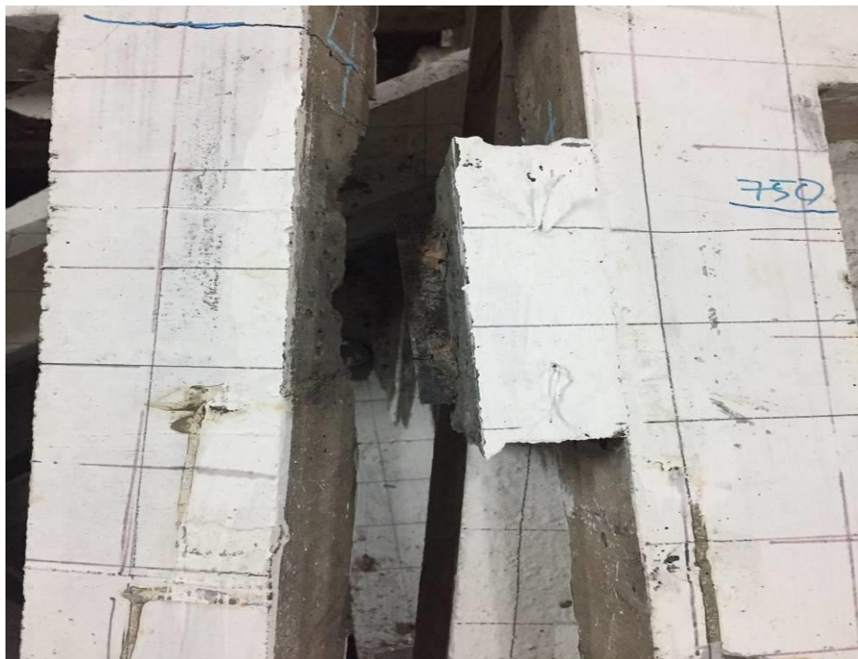
Gambar 4.28 Kondisi terakhir retakan pada kuda-kuda Tipe B
