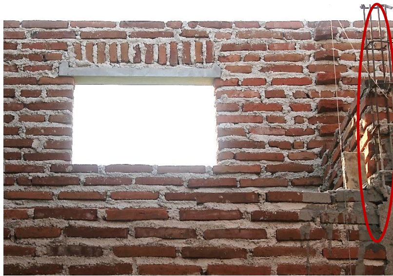
Gambar 4.6 Kolom praktis pada survei 1
