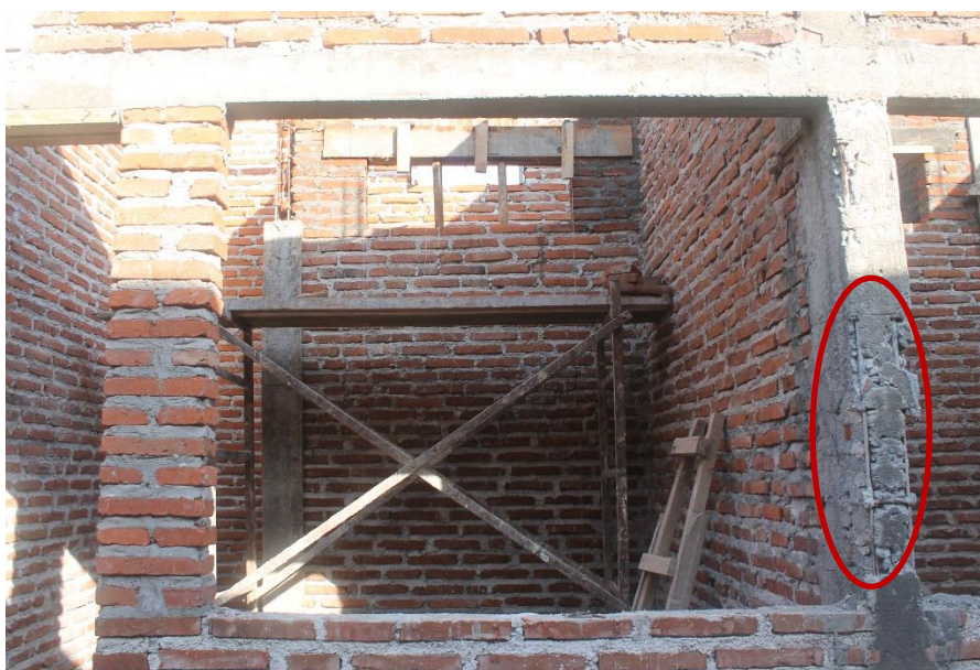
Gambar 4.38 Mutu beton yang kurang baik
