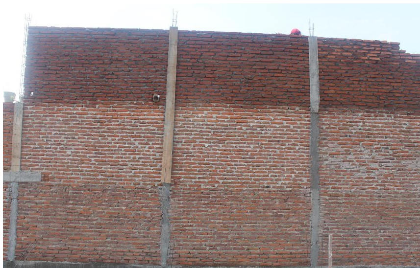
Gambar 4.24 Kolom praktis pada survei 3
