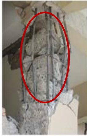
Gambar 4.39 Kurangnya lekatan antara beton dengan tulangan
