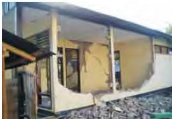
Gambar 4.47 Keruntuhan dinding disebabkan tidak terdapat kolom praktis Sumber : Boen,T., dkk (2010)
