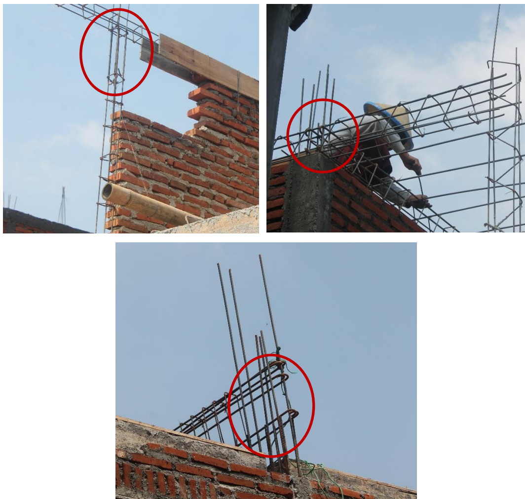
Gambar 4.41 Sambungan balok kolom yang kurang tepat pada survei lapangan
