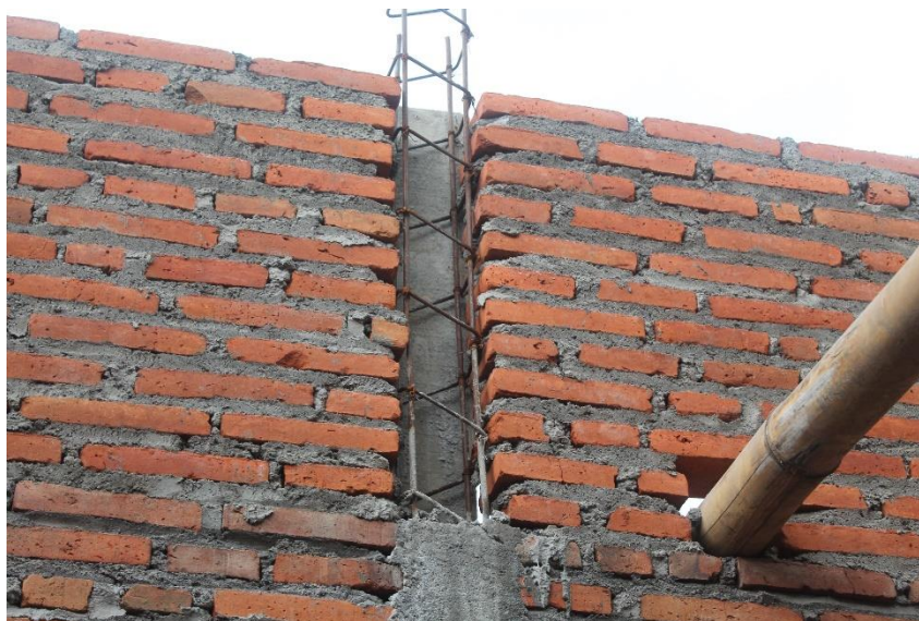
Gambar 4.15 Kolom praktis pada survei 2
