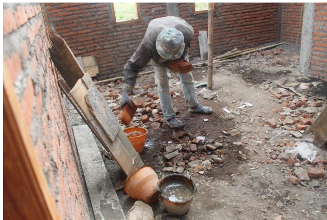
Gambar 4.18 Teknik perendaman dinding bata pada survei 2
