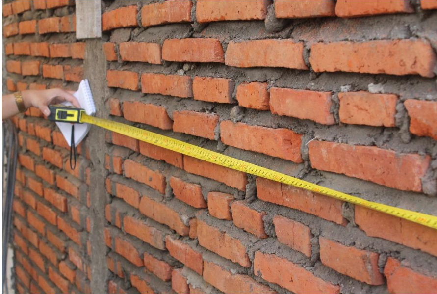
Gambar 4.33 Kolom praktis pada survei 4
