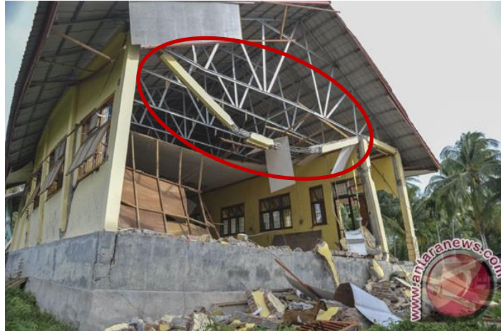
Gambar 4.42 Keruntuhan akibat sambungan balok kolom kurang tepat Sumber : http://www.pojokjogja.com/news/nasional/2017/04/24/enam-rumahrusak-akibatgempa-di-tasikmalaya/
