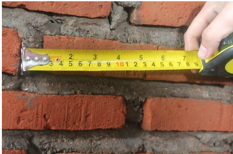
Gambar 4.32 Spesi pasangan dinding bata pada survei 4
