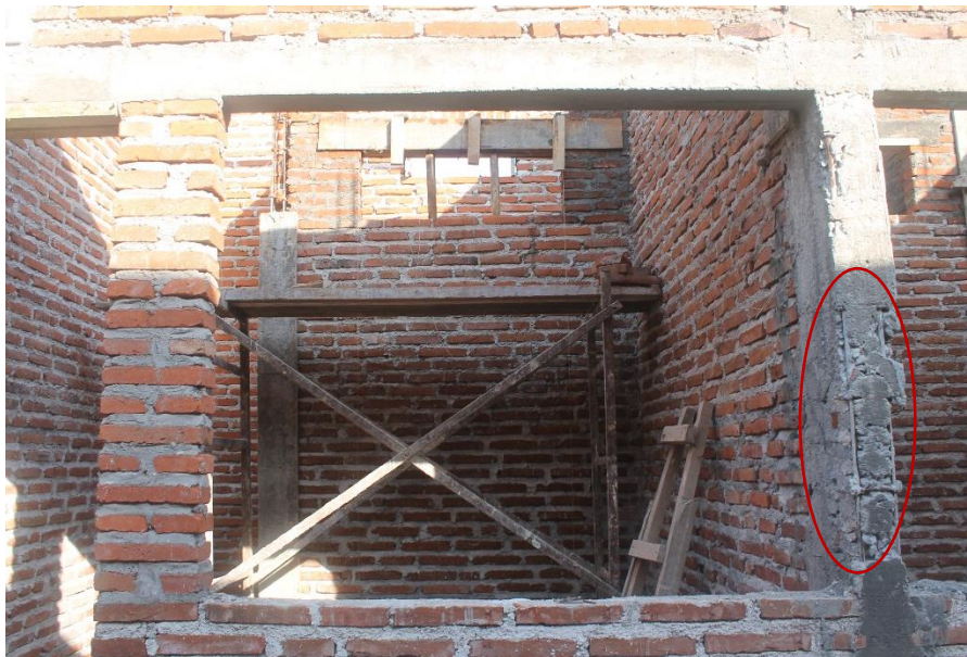
Gambar 4.38 Mutu beton yang kurang baik
