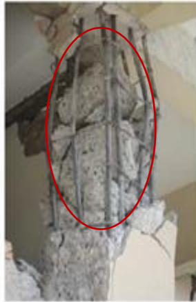
Gambar 4.39 Kurangnya lekatan antara beton dengan tulangan Sumber: http://www.vedcmalang.com/pppstkboemlg/index.php/menuutama/departemenbangunan-30/1274-2
