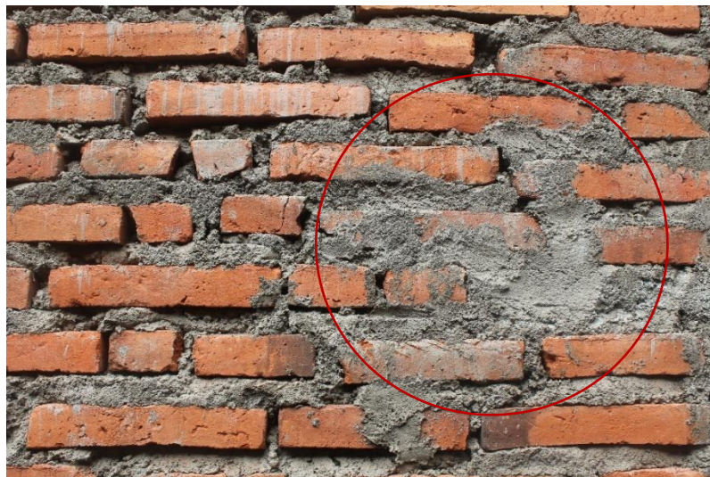
Gambar 4.40 Mortar pasangan dinding bata yang kurang baik
