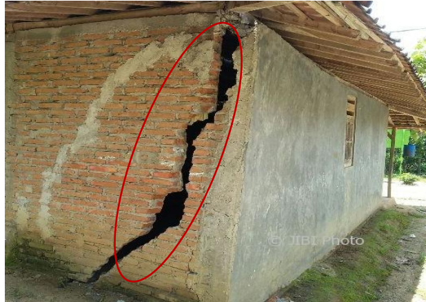
Gambar 4.44 Tidak adanya angkur pada pemasangan dinding bata Sumber : http://www.solopos.com/2017/04/19/bencana-ponorogo-sudah-aman-ratusanwarga-dayakan-boleh-kembali-ke-rumah-810950
