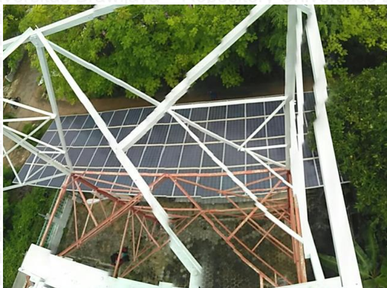
Gambar 4.9 Panel Surya pada BTS PT.Telkomsel Giligenting
