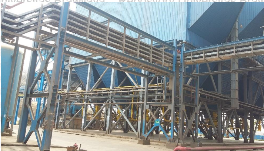
Pipa Transmisi Fly Ash menuju ESP
