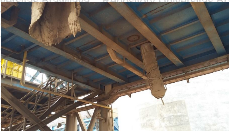
Selang Pembuangan Dari Silo
