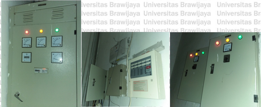
Gambar 5.10 Panel LVMDP (kWh meter) dan panel sistem telekomunikasi
