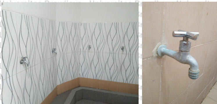
Gambar 5.11 Kran air standard pada area tempat wudhu
