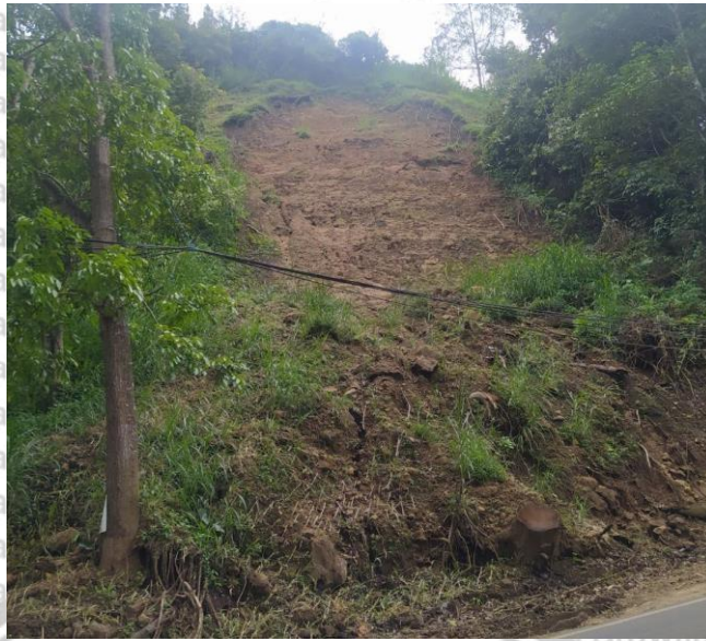
Gambar 1.1. Kondisi lereng di lapangan
