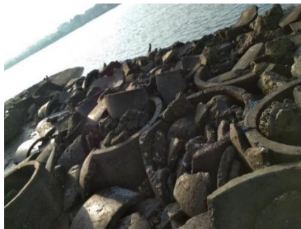
Gambar 6. Tatanan ujung Brok Dowo yang rusak Sumber: Pribadi
