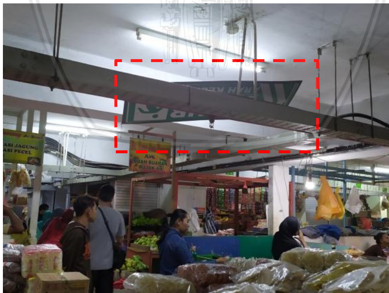
Gambar 4.28 signage yang rusak
