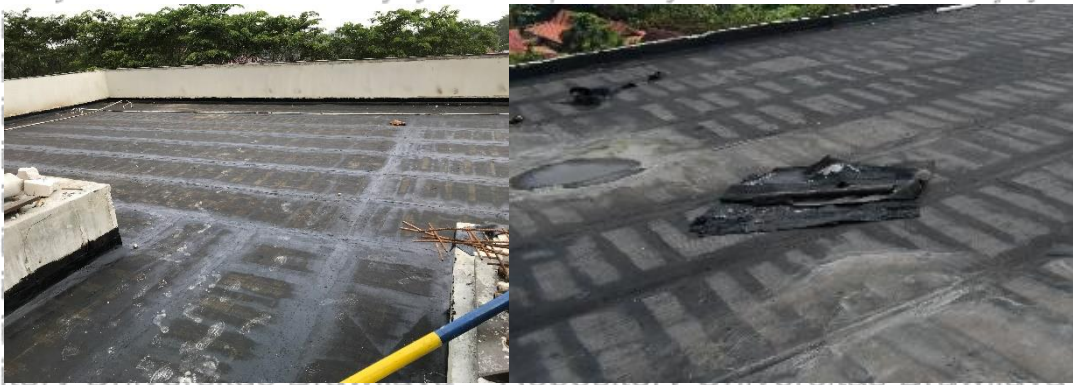
Gambar 4.141 Sisa Material Pada Pekerjaan Membran Waterproofing
