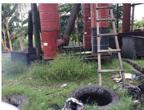
Gambar 4.19 Tempat Penampungan Limbah Insenerator
