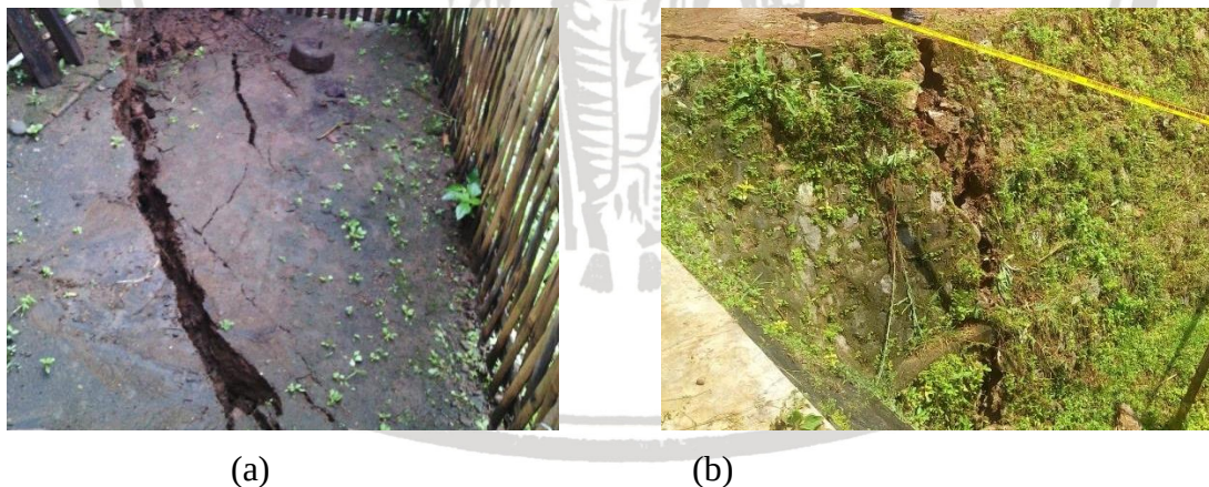
Gambar 4. 6 Retakan Tanah yang terjadi di Desa Pohgajih
