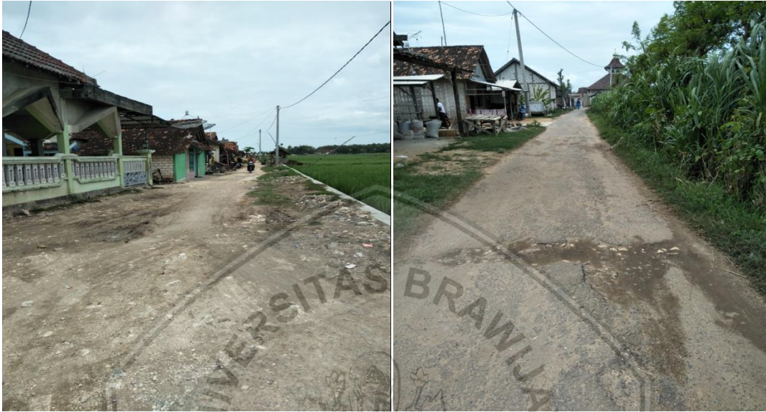
Kondisi Jalan Lingkungan Dusun Karang Duwur
