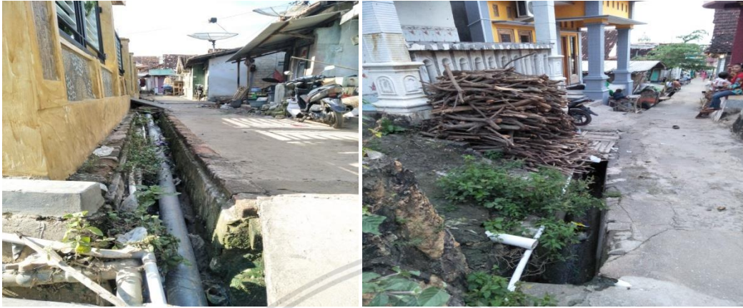
Kondisi Saluran Air di Dusun Binangun yang sudah rusak
