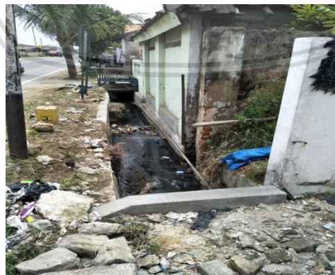
Kondisi Saluran Air di Dusun Karang Gayam yang rusak
