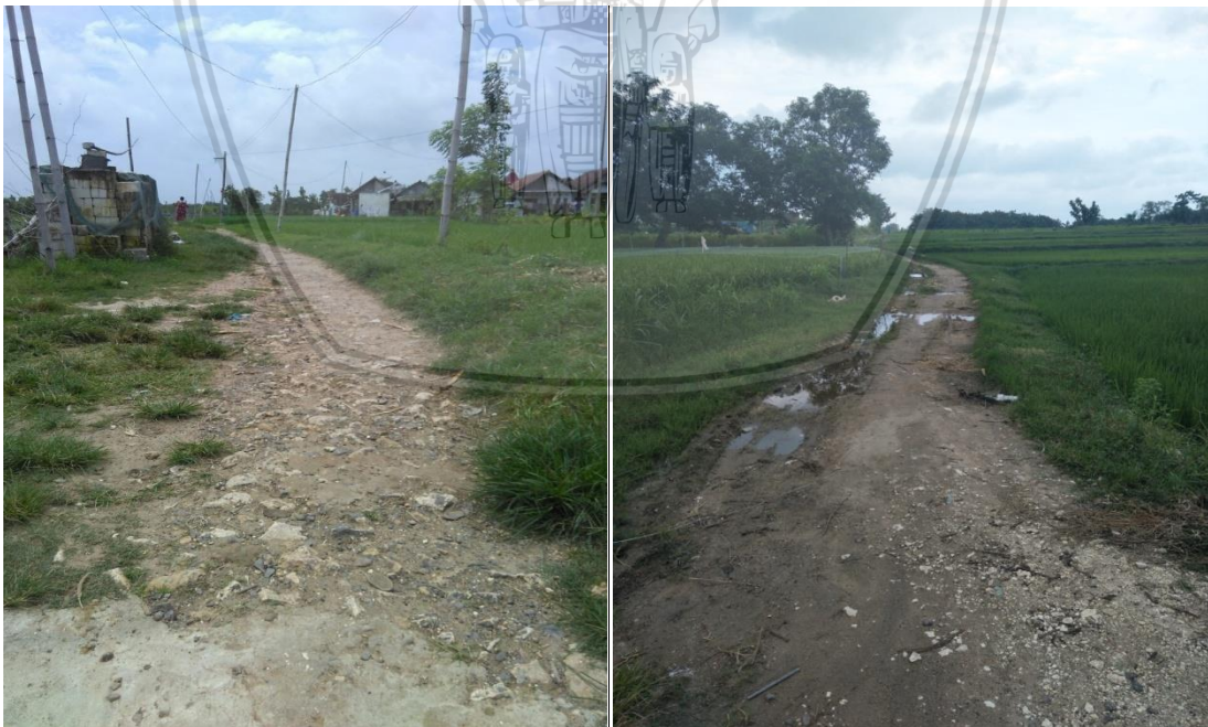
Kondisi Jalan Lingkungan Dusun Binangun
