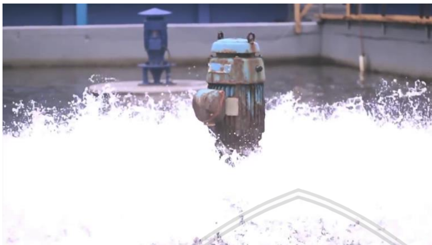
Gambar 4.40. Bak Aerasi Sumber : dokumentasi pribadi
