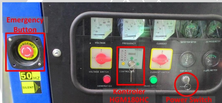
Gambar 2. 3 Bagian-bagian panel genset Jurusan Teknik Elektro
