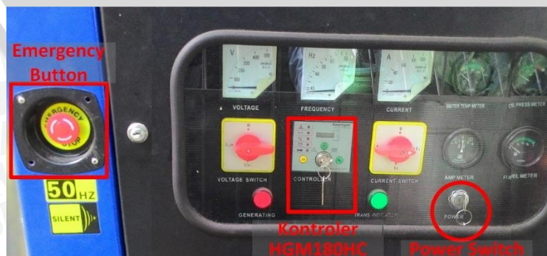
Gambar 3. 6 Bagian-bagian pada panel genset
