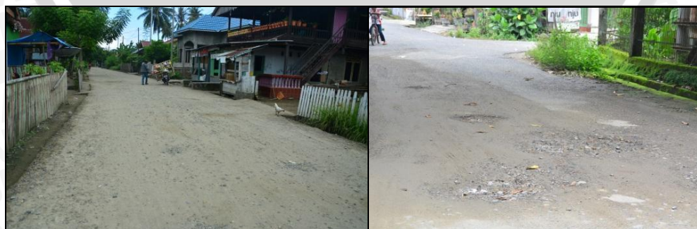
Gambar 4. 24 Kondisi jalan di daratan pesisir Desa Tonyaman. Sumber : Survei Primer, 2016
