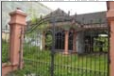
Gambar 4.15 Kondisi Eksisting Rumah Dengan Kondisi Tidak Baik Di Jalan Trunojoyo
