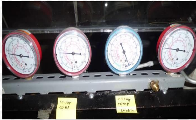
Gambar 3.10 Pressure gauge Sumber : Arsip pribadi
