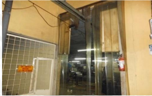
Gambar 4.5 Kondisi Pintu Tirai Plastik
