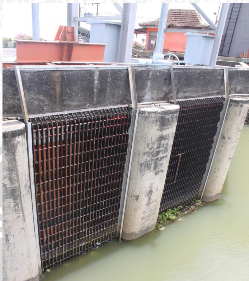
Gambar 4.5. Pintu Intake Irigasi Lodagung
