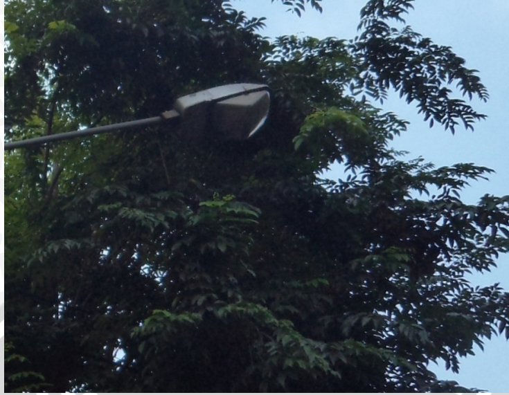
Gambar 4.4 Kap Lampu Terpasang di Lapangan
