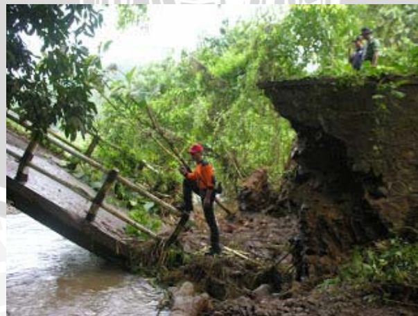
Gambar 3.5 Jembatan Putus Di Desa Gumeng Sumber: Survey
