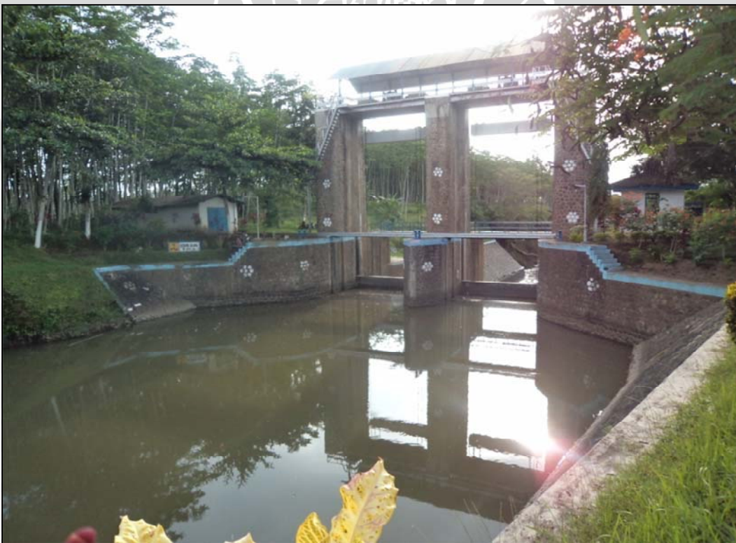
Gambar 3. 3 Dam Talang Sumber : Dokumentasi Hasil Survei
