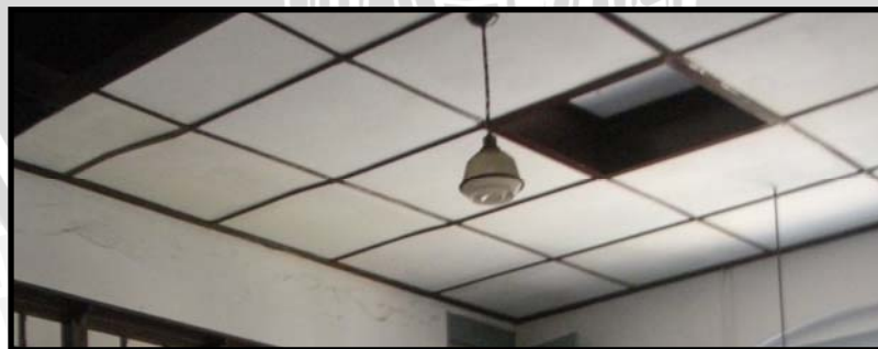
Gambar 4.156. Plafond Laboratorium Kimia Tanah
