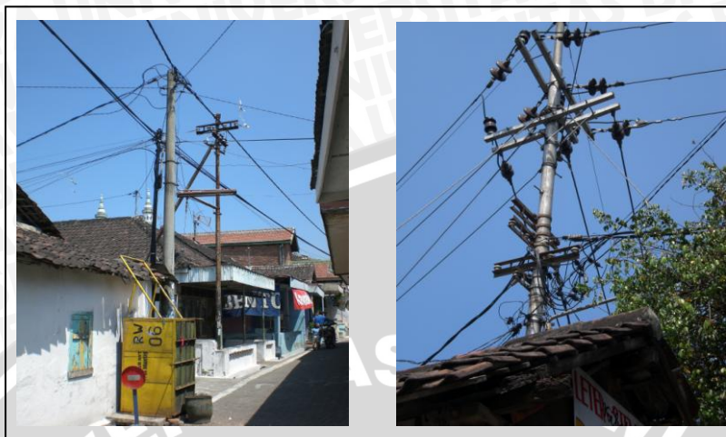
Gambar 4.42 Kondisi Jaringan Listrik Di Wilayah Kelurahan Jodipan
