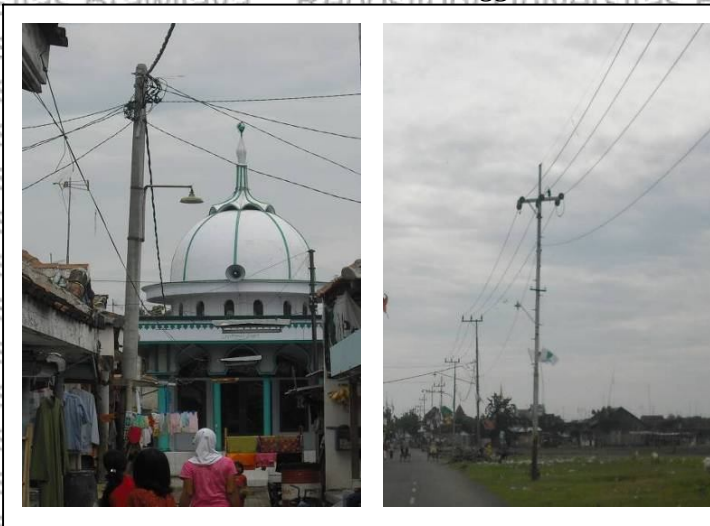
Gambar 4. 36 Kondisi jaringan listrik di wilayah Kelurahan Panggungrejo
