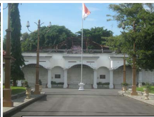
Kondisi pendopo akibat dibakar massa pada kerusuhan Pilkada 2006
