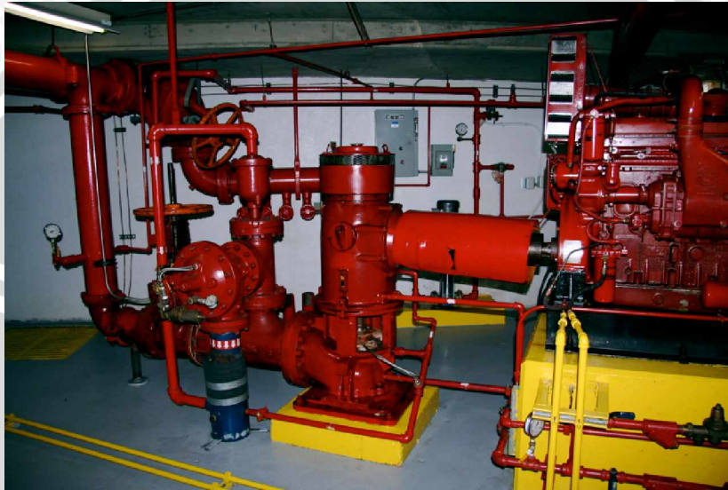
Gambar 2.2 Instalasi Fire Pump dengan mesin Diesel
