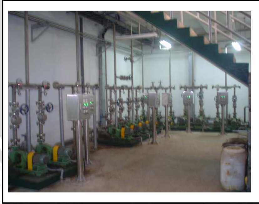
Ruang Mesin dan Pompa
