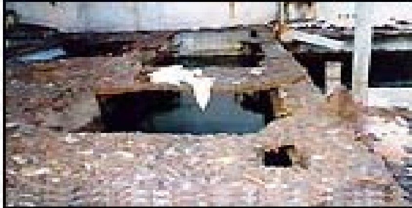
Gambar 2.12 Korosi Permukaan Merata Sumber: http://corrosion.ksc.nasa.gov
