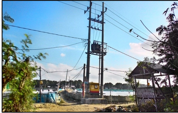
Gambar6. Gardu listrik utama yang mempunyai peranan sangat penting dalam usaha budidaya udang vaname, karena sebagai sumber energi untuk berbagai macam peralatan penunjang kegiatan operasional.
