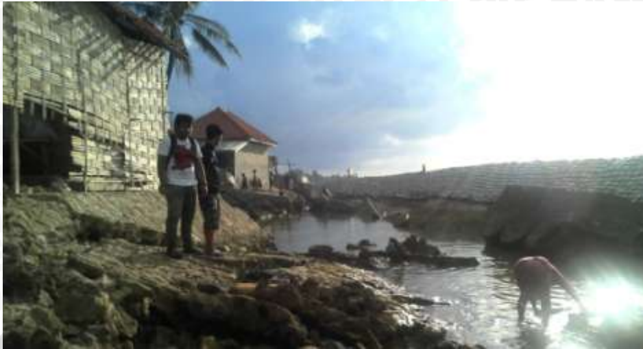
Gambar 26. Kondisi lapang dan seawall.
