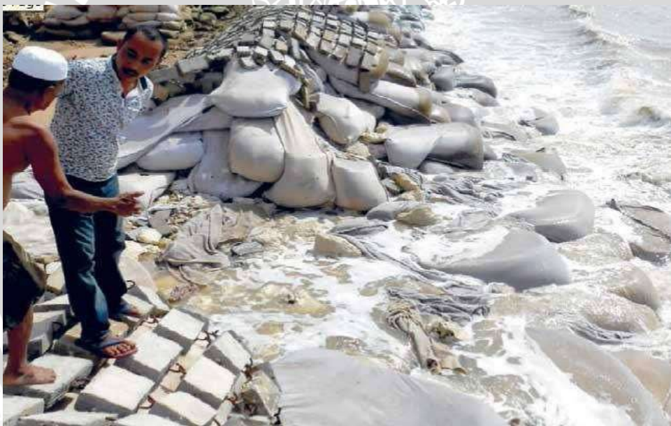
Gambar 30. Bangunan seawall hanyut oleh hempasan gelombang (Radarmadura,2014)
