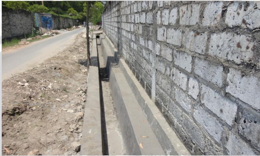
Gambar 7. Saluran Drainase Desa Jenu
