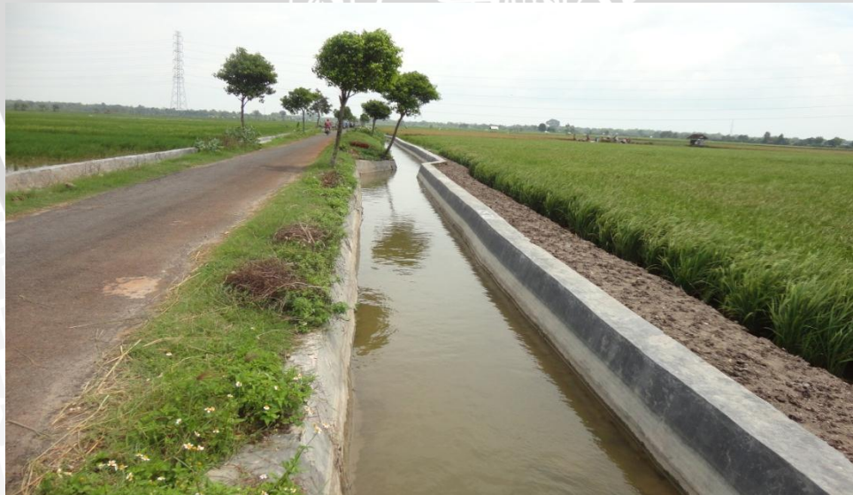
Gambar 8. Saluran Irigasi yang Telah Dibangun
