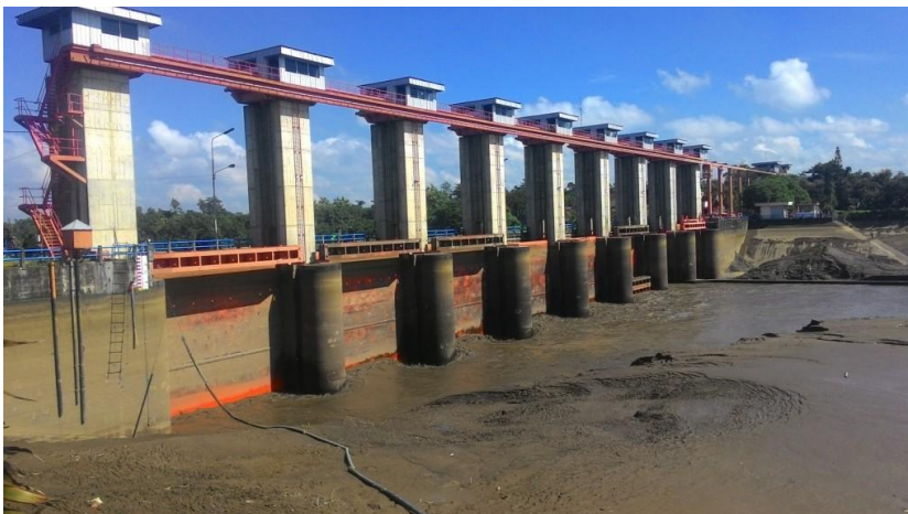
Kondisi Bendung Lodoyo setelah dilakukan flushing
