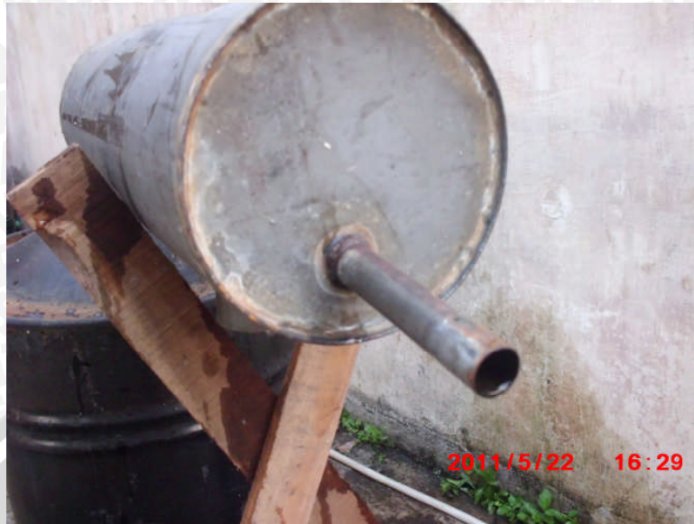
Gambar Lampiran 5. Ujung dari pipa pendingin, bagian ini adalah saluran akhir asap dari tungku pembakaran, dan bagian tersebut adalah saluran keluarnya hasil akir dari proses pembuatan asap cair
