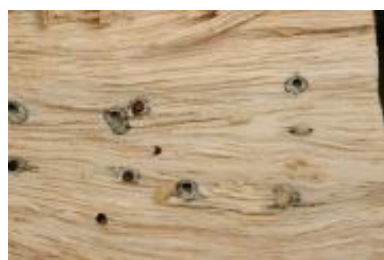
Gambar 4. Dampak Kerusakan Kumbang Ambrosia (Bumungsri, 2008).
