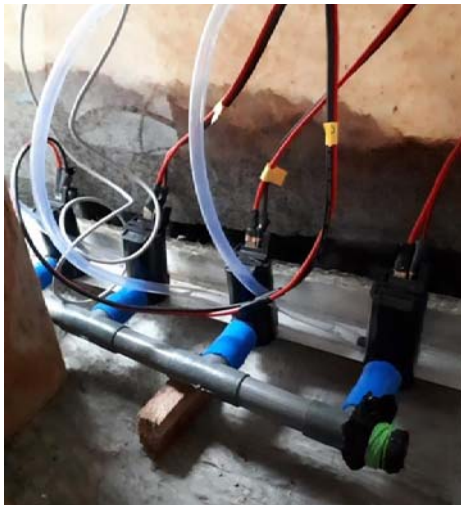
Gambar 4.5 Posisi Pompa Air
