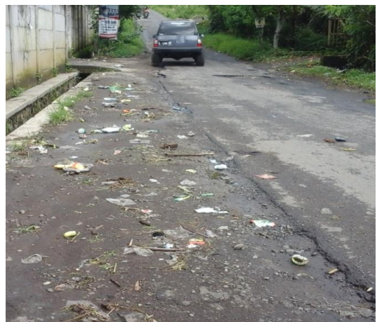
Kondisi jalan setelah hujan
