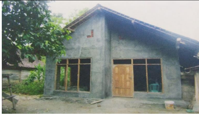
Gambar 17: Kondisi rumah Bp. Abidin 50%
