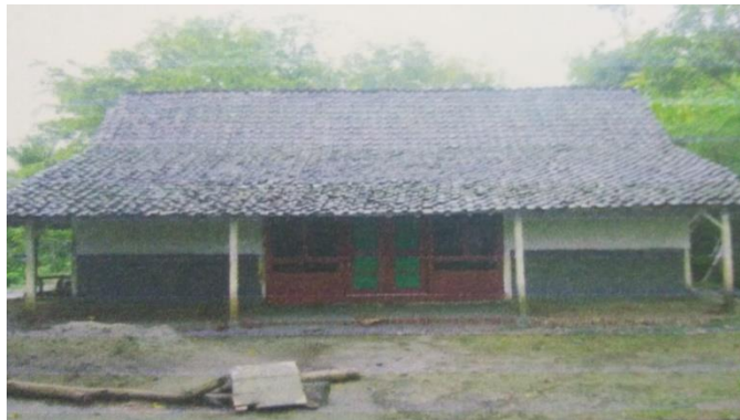
Gambar 14: Kondisi rumah Bp. Landep 50%
