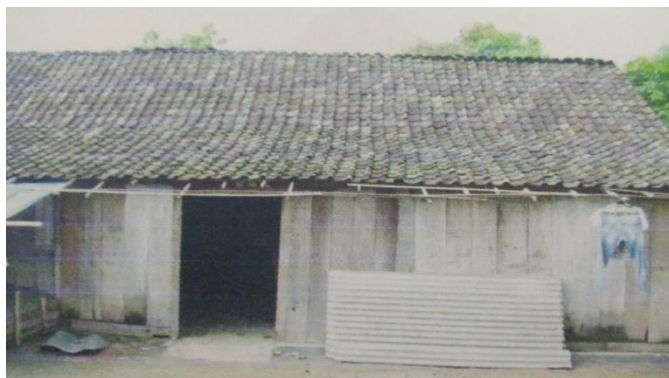
Gambar13: Kondisi rumah Bp. Landep 0%
