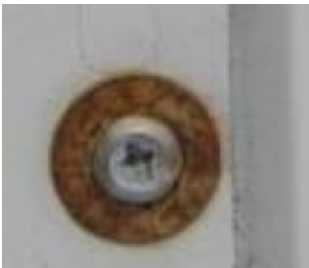
Gambar 2.3 Korosi galvanik pada sambungan baut
