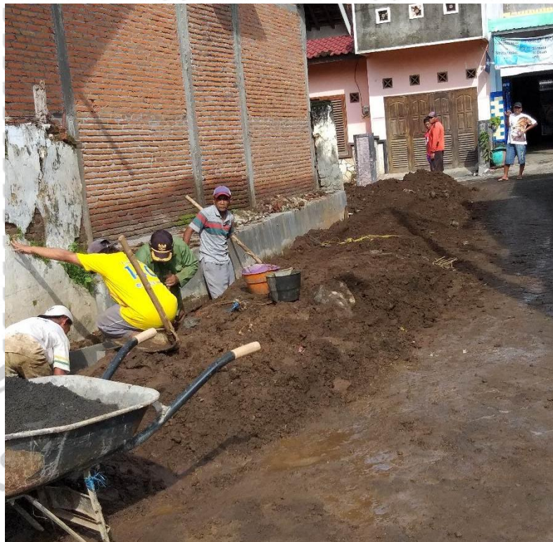
Gambar 10 : Gotong royong yang dilakukan masyarakat untuk memperbaiki jalan yang rusak. Sumber : Dokumentasi Peneliti
