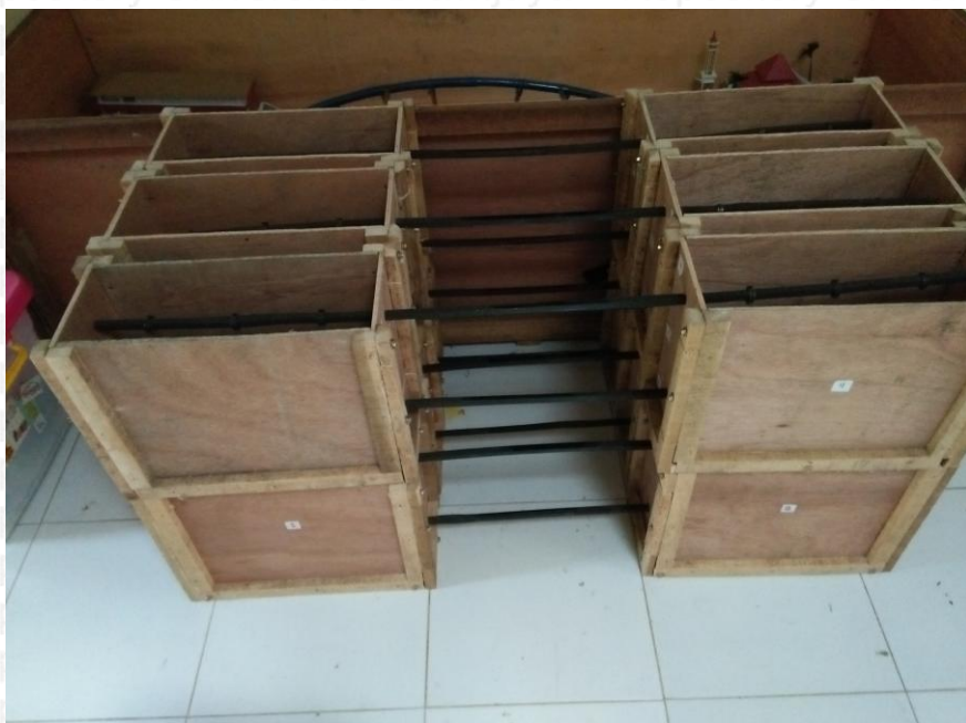
Gambar Bekesting dan tulangan bambu yang sudah terpasang dan siap untuk proses pengecoran
