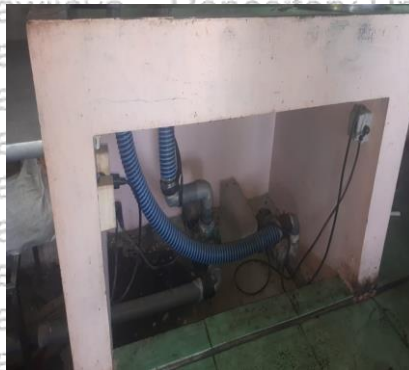
Sumber : (Dokumentasi Lapangan) Gambar 4. Pompa Air
