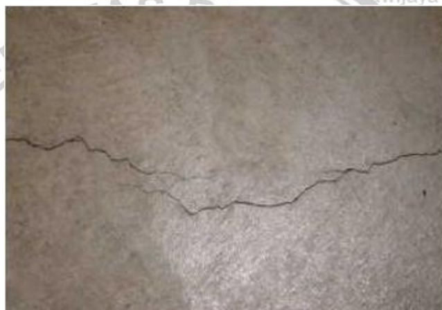
Gambar 2. 16 Gambar Retak Kering
