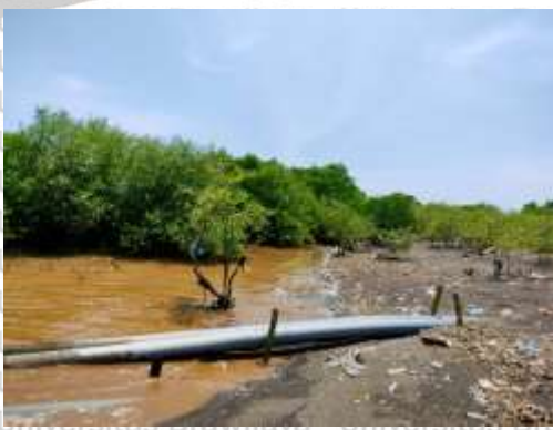
Pipa Masuknya Air Tambak
