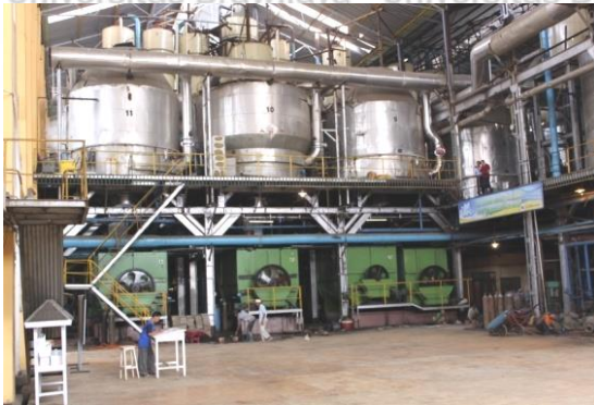
Gambar 4.5 Stasiun masakan 4. Stasiun Puteran
