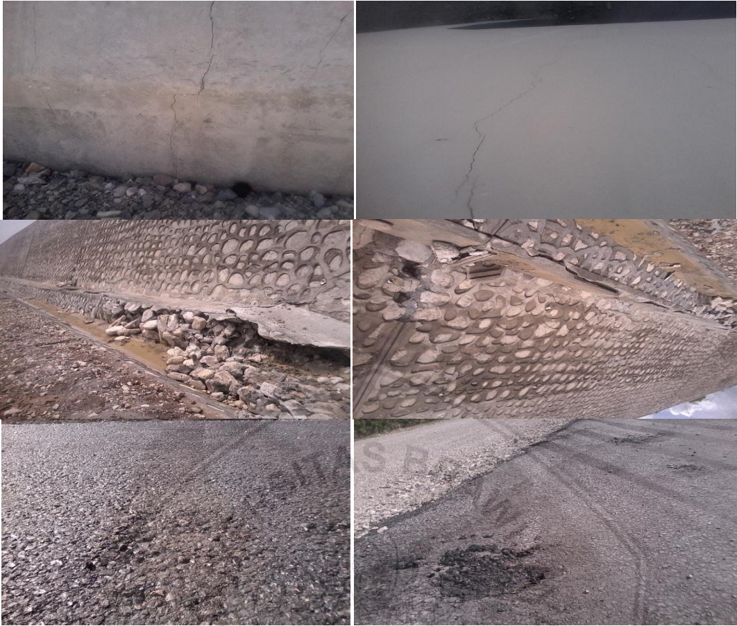
Risiko banjir yang merusak pada pekerjaan tembok penahan dan pekerjaan yang tidak berkualitas
